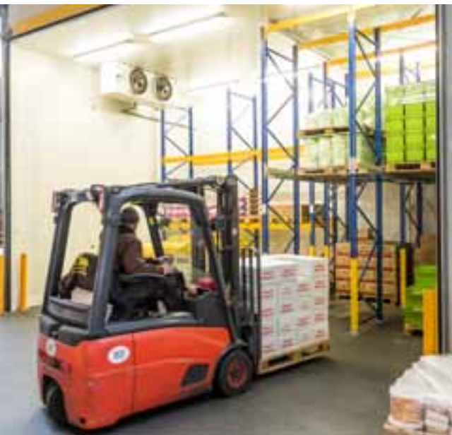
In den vier Kühlzellen sorgt je ein „GEA Küba SGBE“-Luftkühler für die richtige Temperatur in allen Bereichen der Kühlzelle.
